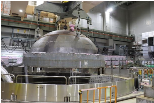
原子炉圧力容器上蓋の写真
